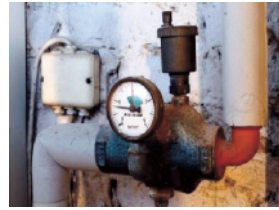
Manómetro conectado a una tubería.
